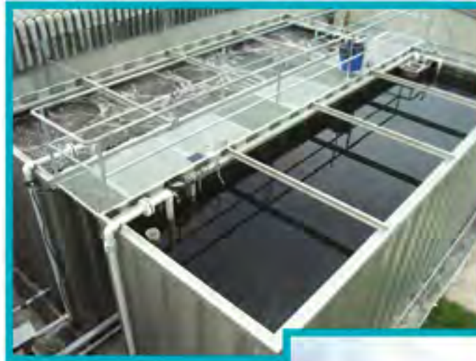
PMS Polietilen Mamulleri Ltd. Şti. Paket Tip Biyolojik Atıksu Arıtma Tesisi - Kemalpaşa / İZMİR 2003 10 m 3 /gün - 50 kişi E.N.
