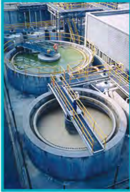
TOYOTASA A.Ş. Kimyasal Atıksu Arıtma Tesisi ADAPAZARI 1994 960 m 3 /gün Kapasiteli
